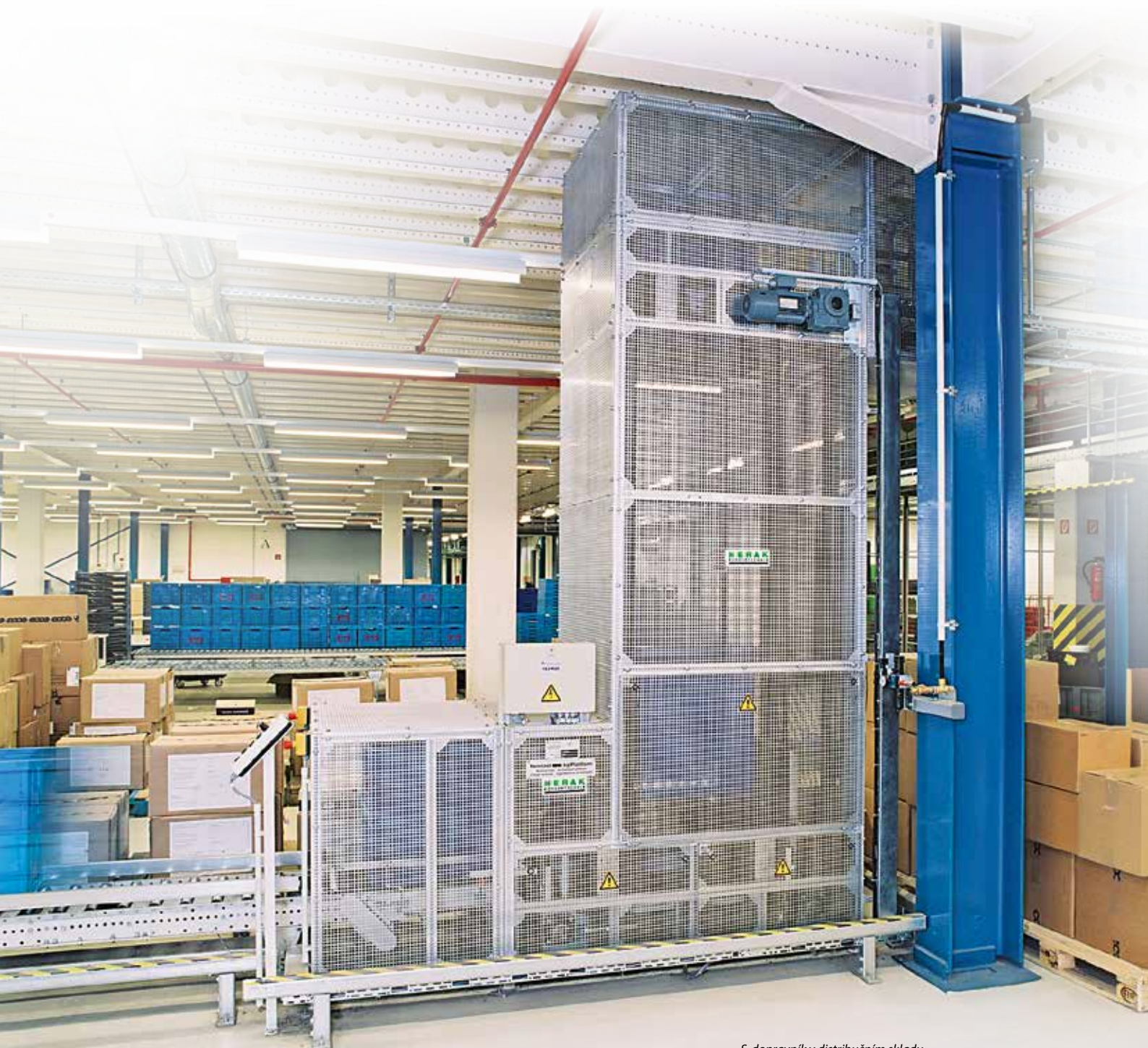
S-dopravník v distribučním skladu
